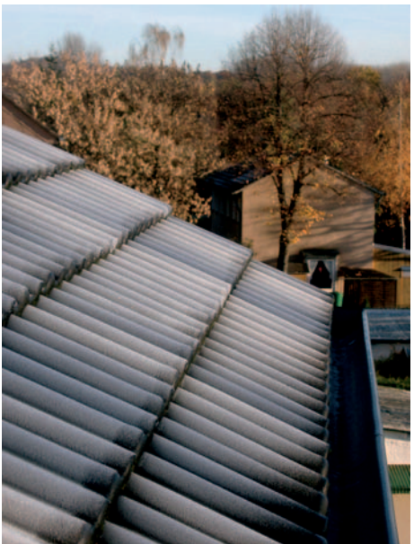
Der getaute Reif an der Unterkante der Dachziegel zeigt den Transmissionswärmeverlust eines ungedämmten Dachs.
